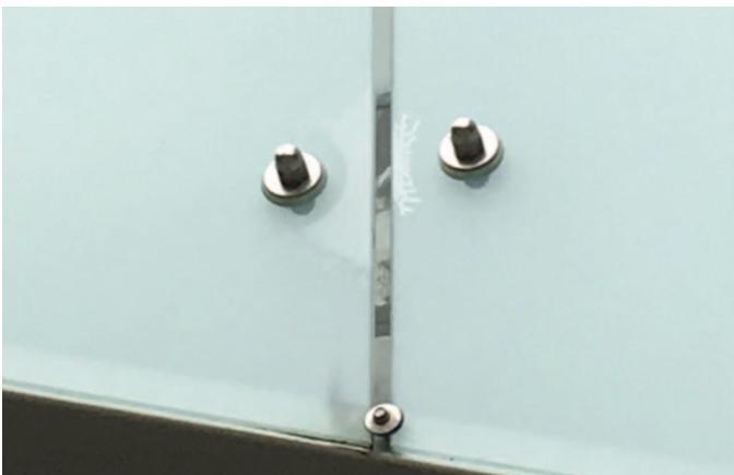
Billede 2: Delaminering i området rundt om boltfastholdelse skyldes ofte forkert hulplacering og/eller for hård tilspænding.
